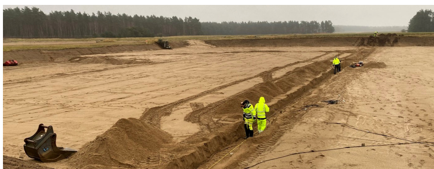
Mätinstrument placeras i sanden på en infiltrationsdamm. Foto: Sydsvatten
